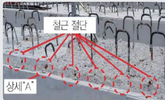
거더 스테럽철근 임의 절단
