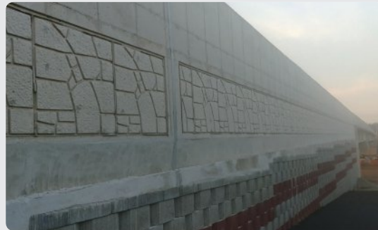
시공이음(수평) 마감 개선
