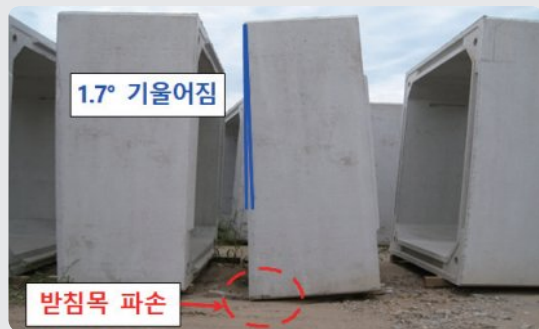
고임목 설치 부적정(기울어짐)
