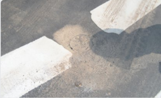
철개 마감높이 미흡(물고임)
