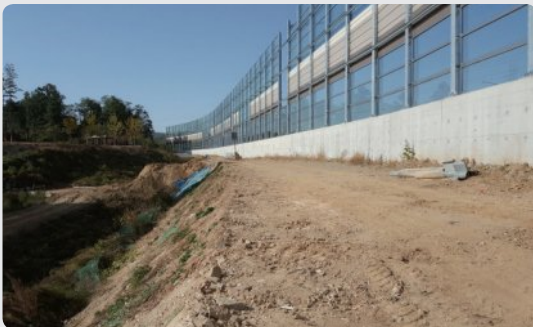
도로 끝부분 시인성 부족
