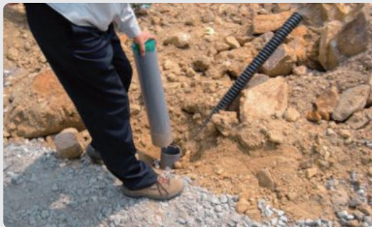
분기관 표식(ELP관) 파손
