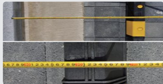
차막이용 경계블록 설치위치 미흡
