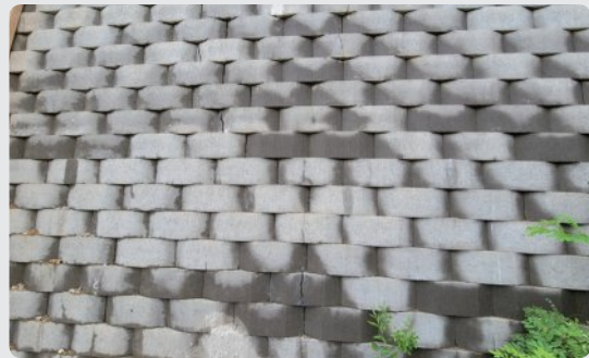
균열 관리 부적정
