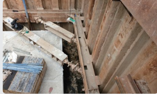
추락위험구간 안전시설 미비
