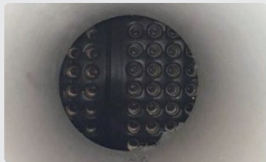
배수구멍 설치 부적정(드레인보드 미절단)
