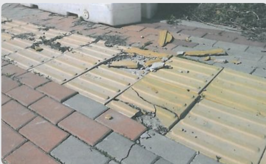
불량자재 시공(재료부리 발생)
