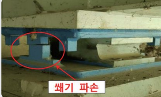
탄성받침 뺨기 파손
