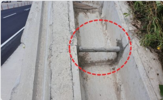
옹벽(네일) - 측구 간섭(검토 미흡)
