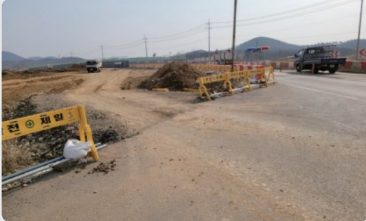
세륜시설 설치 누락(토사 유출발생)
