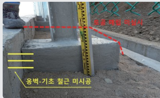
기초부(옹벽형) 시공 부적정
