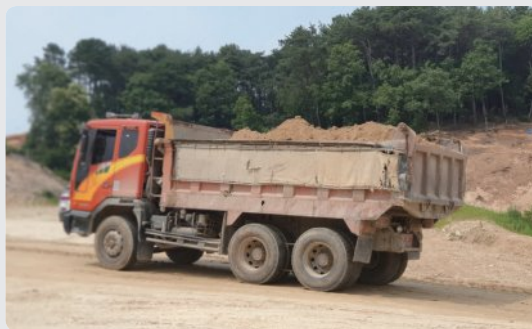
운반차량 덮개 설치 미흡
