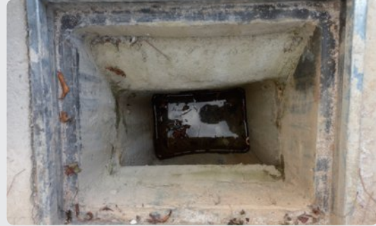
단면 부족(변형·파손 발생)
