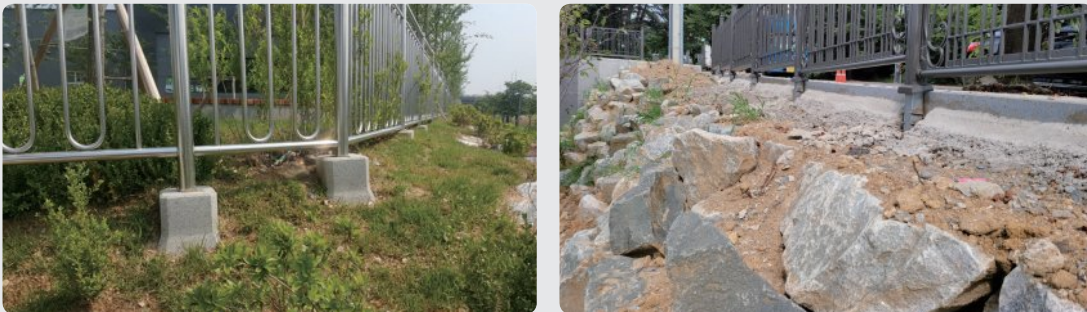
기초 시공 부적정(노출, 되메우기 미흡)
