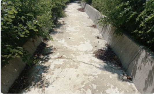
측구 균열 발생(줄눈 미설치)
