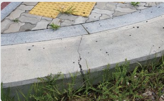
측구 균열(줄눈 누락)
