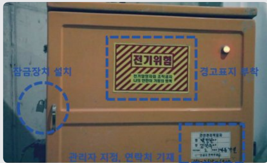
배전반 설치·관리 양호
