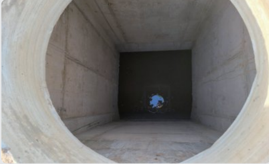
발디딤쇠 미설치(슬래브 완료 상태)
