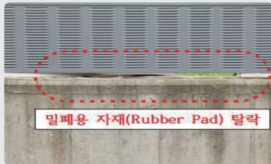
방음판 하부 패드 탈락
