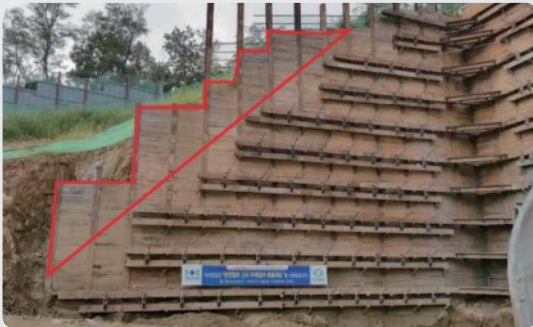
지보공 설치 누락(추가시공부)
