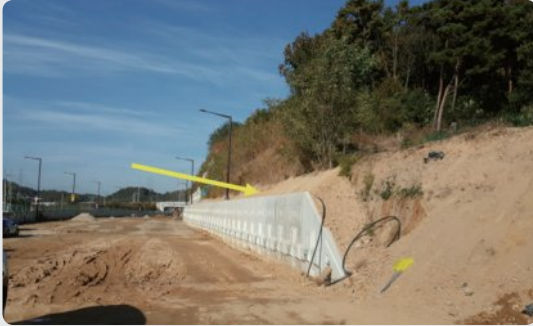
상부 배수(차수)시설 미비
