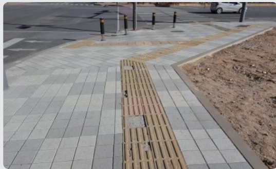
장애인 유도블록 파손
