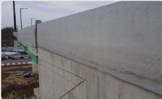
시공이음(수평) 마감 개선
