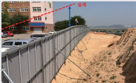
설치 높이 부적정(설계6m)
