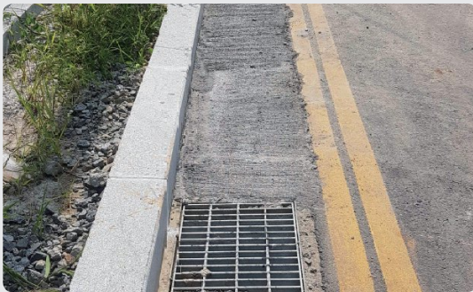
손상구간 보수 부적정(덧씌우기)
