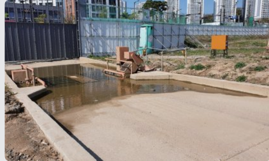
세륜시설 미작동(전원 미공급)
