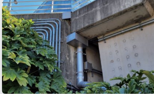
신축이음부 유도배수 양호
