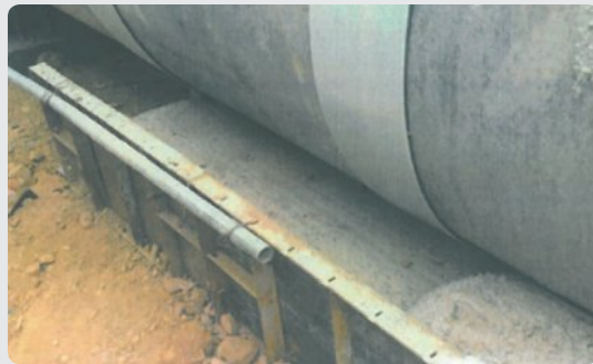
관-수밀벨트 밀착상태 개선
