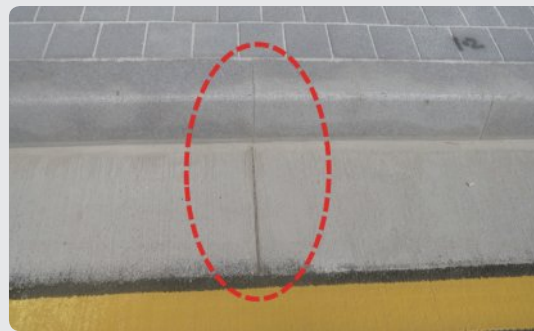
줄눈 설치 적정(측구 - 경계블록 상호 일치)
