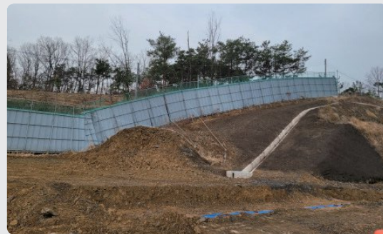
설치 형태 부적정(경사시공)
