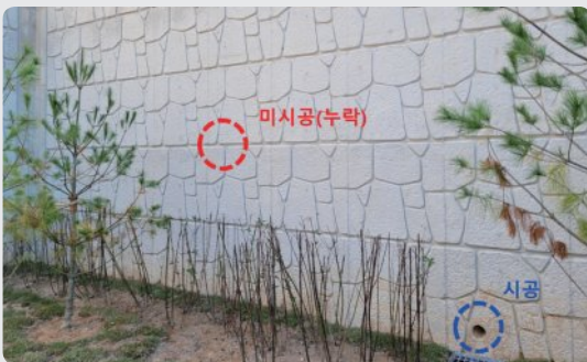
배수구멍 설치 부적정(누락)
