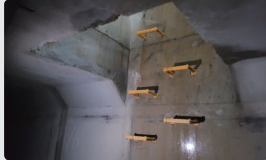
암거 현치 간섭부 처리 양호
