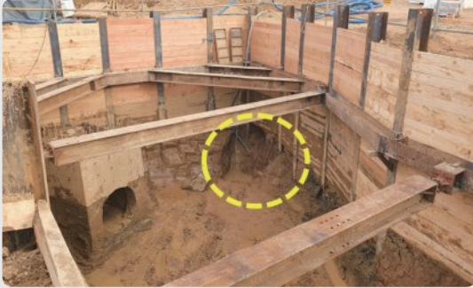
토류벽 미시공(터파기 과다)
