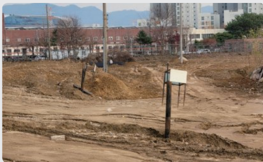
공사 중 훼손
