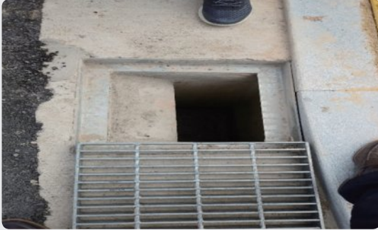
설치위치 부적정(측구 간섭)
