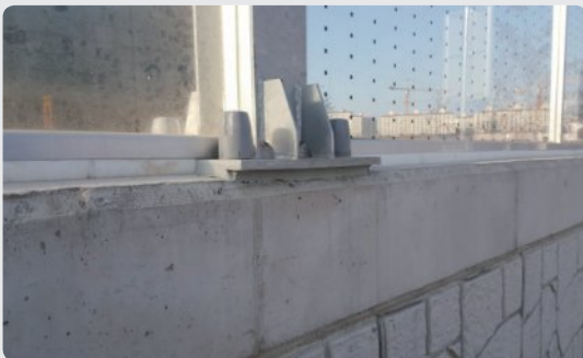
기초 콘크리트 단면 부족
