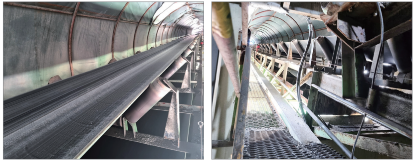
벨트 컨베이어 내·외부 전경
