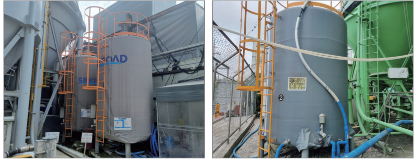
혼화제 탱크 전경
