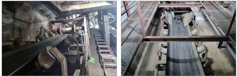
골재 호퍼 하부 벨트 컨베이어 전경
