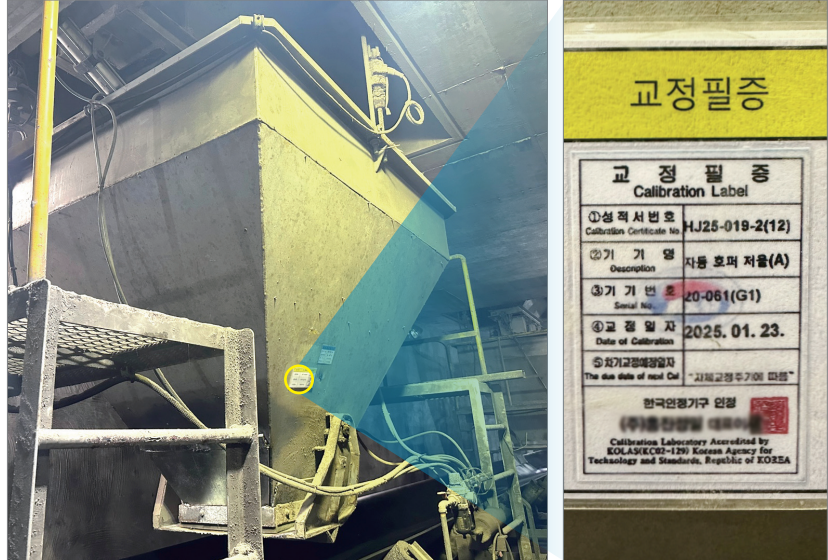
계량 장치(호퍼저울) 전경 및 교정필증
