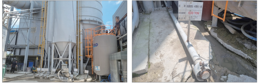
시멘트 투입구 풍화 방지 장치 및 시건 상태
