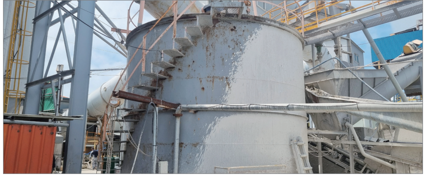
회수수 교반시설 전경
