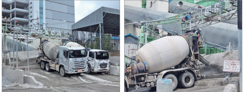
회수수 처리(집수)시설 전경
