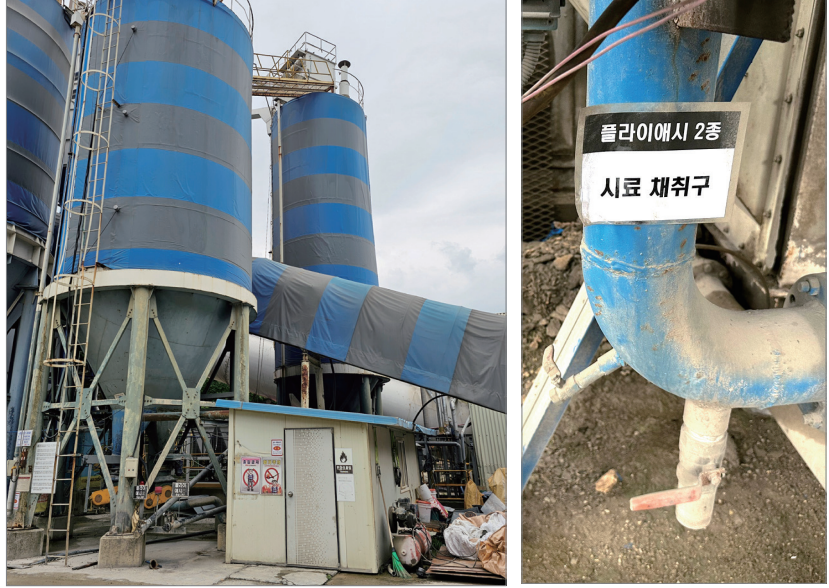
혼화재 사일로 전경 및 시료채취구
